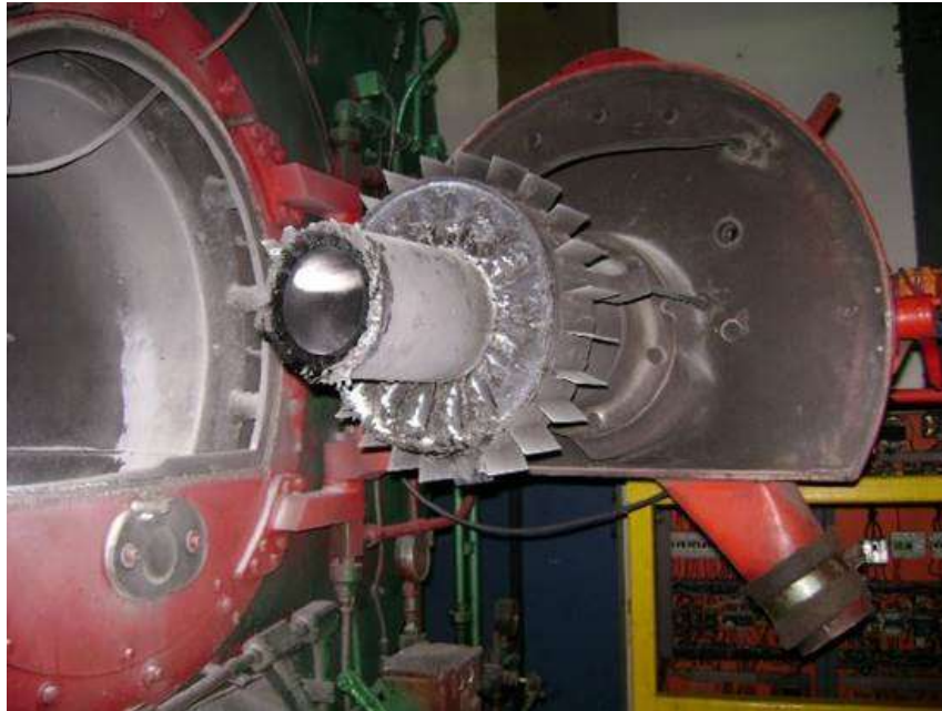
Figura 22 - Copo rotativo e difusor impregnados de borra de coque.
