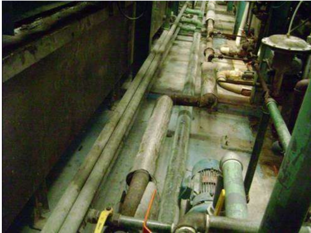
Figura 19 - Sistema de isolamento térmico danificado.
