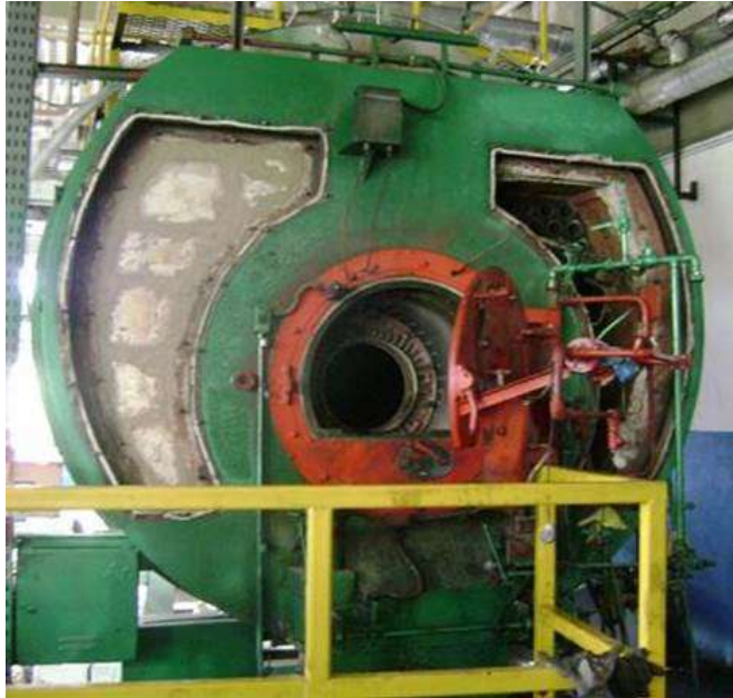
Figura 21 - Refratário em recuperação lado externo.
