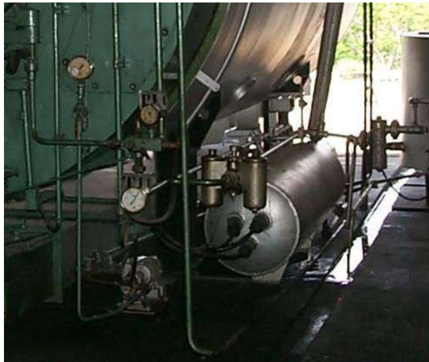
Figura 23 - Novo aquecedor de óleo OC-1A.
