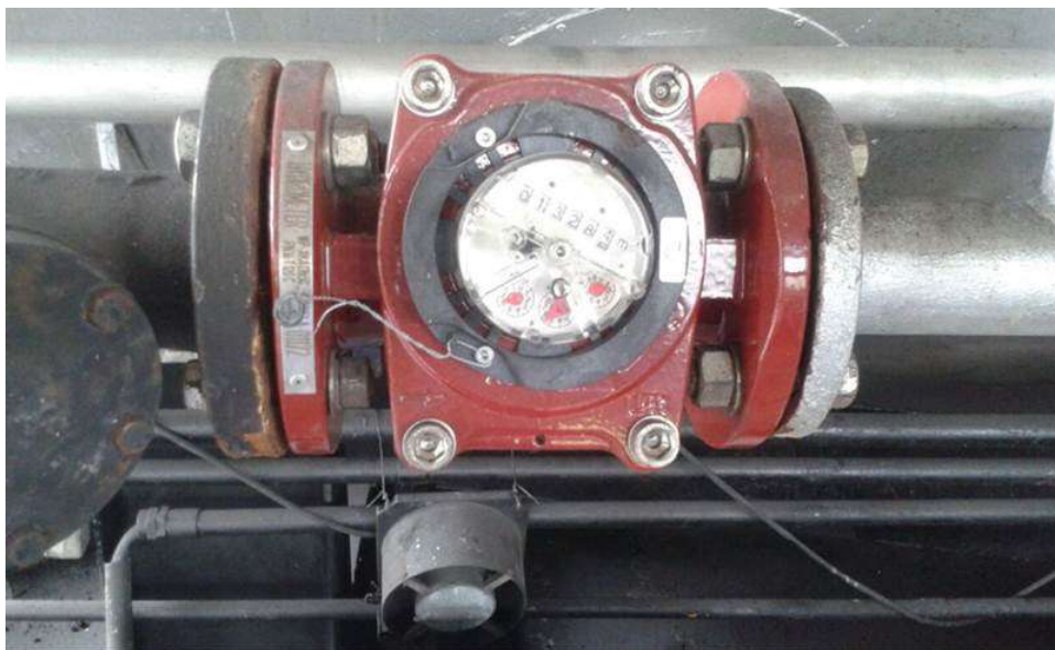
Figura 42 - Medidor de vazão de alimentação de água da caldeira.
