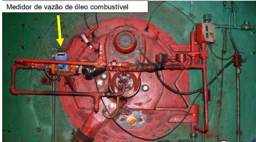
Figura 41 - Medidor de vazão de óleo combustível.
