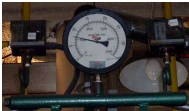
Figura 40 - Manômetro da pressão do vapor.
