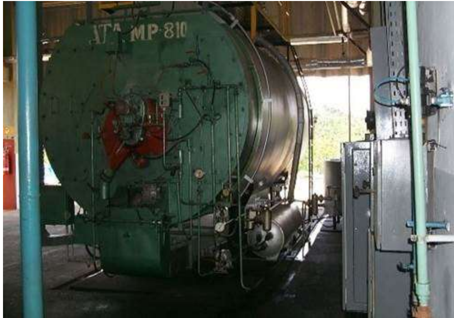
Figura 5 - Caldeira a vapor a vapor d'água estacionária, horizontal fogo tubular.
