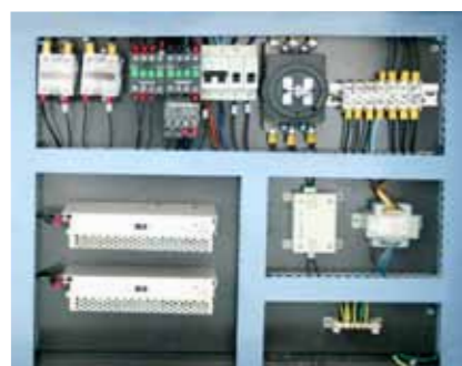
1- Painel de comando
