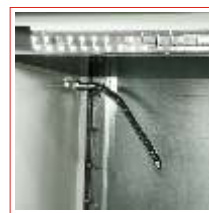
Sistema de refrigeração e iluminação
